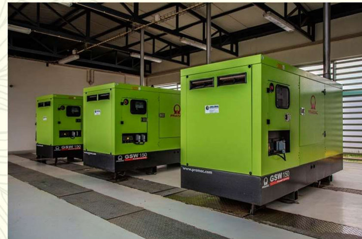
GRUPO GERADOR ALIMENTANDO 100% DO EMPREENDIMENTO
